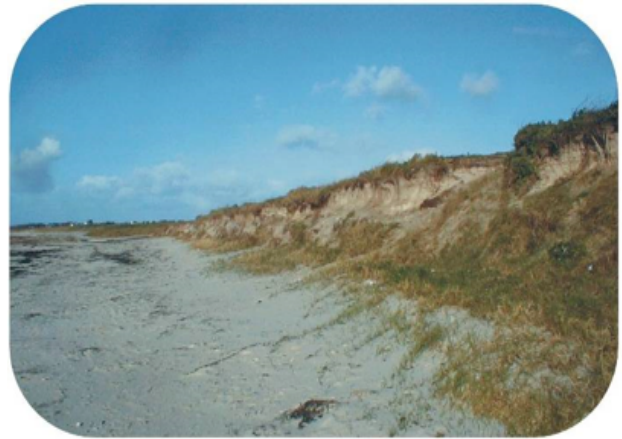
Cordon dunaire de la plage de la Grève Blanche – Le Guilvinec 2002 – Dune avant les travaux
