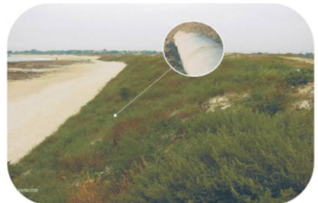
Cordon dunaire de la plage de la Grève Blanche – Le Guilvinec 2005 – Dune après les travaux
